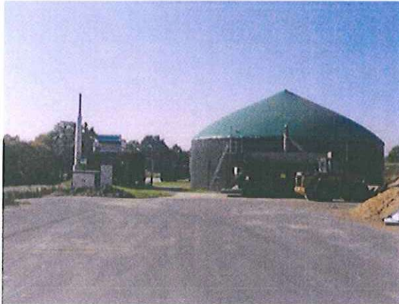
Abb. 6 Fermenter mit Feststoffdosierer, BHKW und Trafo mit erforderlichen Betriebsflächen (P. Scharlibbe Oktober 2010)
