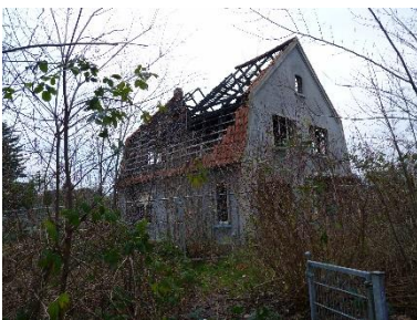
Abb. 104: Hoher Sanierungsbedarf (Schulberg)
