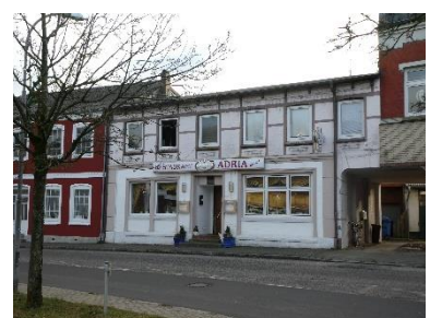
Abb. 102: Mittlerer Sanierungsbedarf (Lehmborgstraße)
