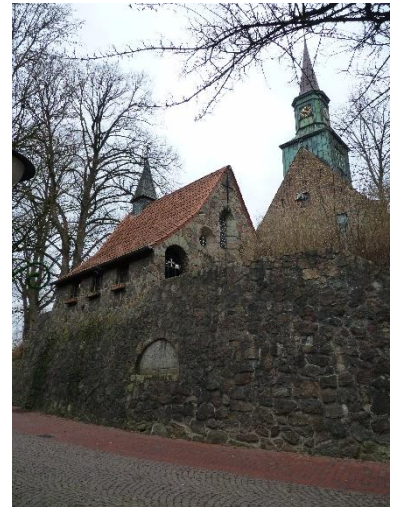
Abb. 113: Sachgesamtheit Kirche St.-Cyriacus: Kirche, Ehrenmalkapelle und Böschungsmauern aus Granit als Teil des Ensembles
