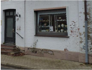
Abb. 230: Substanzschäden am Haus Brauerstraße 14
