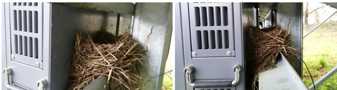
Bild 4.6.1: Beispiel für einen geschützten Nistplatz hinter einem Wechselrichter. (Quelle: SolPEG Anlagenprüfung)
